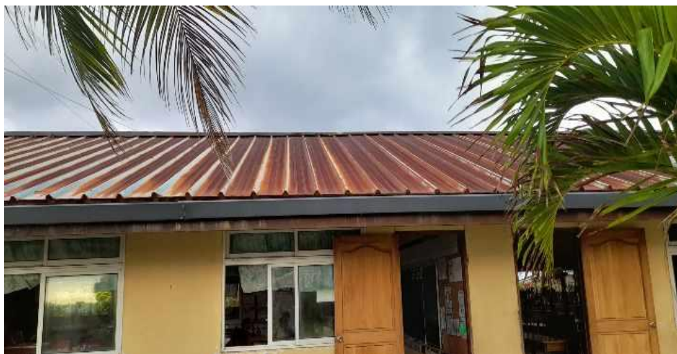
Vue de la détérioration de la couverture
