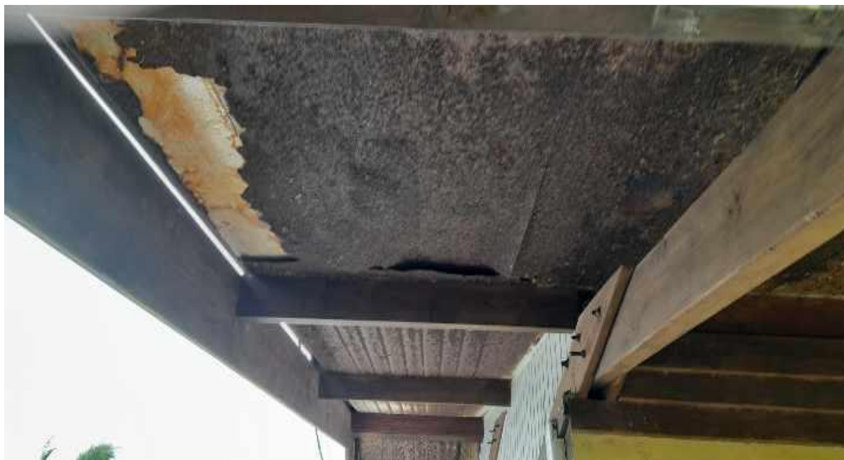
Vue du plafond de la toiture oxydée
